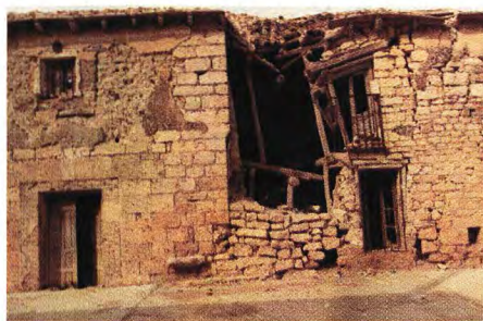
Motivo del trabajo: Deterioro de la edificación. Montealegre
